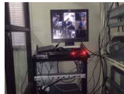
Vista monitoreo circuito cerrado y bastidor central telefónica (antes)
