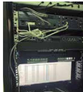
Rack Telefonía y servidores (actual)
