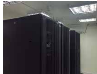
Rack Telefonía, Servidores, Storage, Enlaces (actual)
