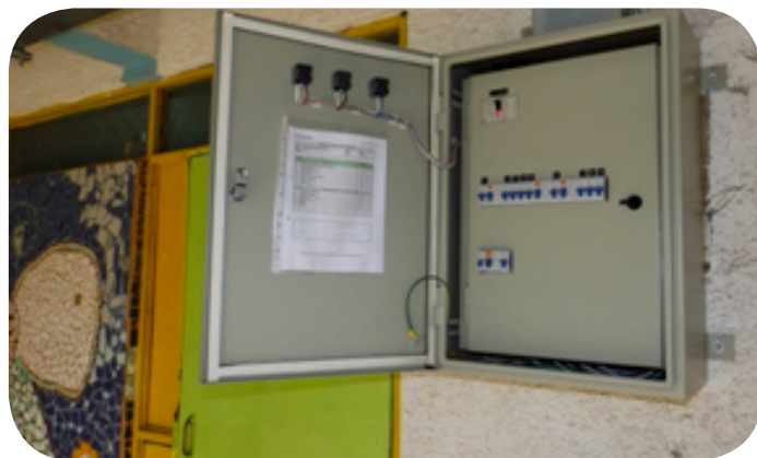
Uno de los 13 tableros de distribución instalados en el Liceo. En la imagen, el tablero del 1er piso del módulo 2.
