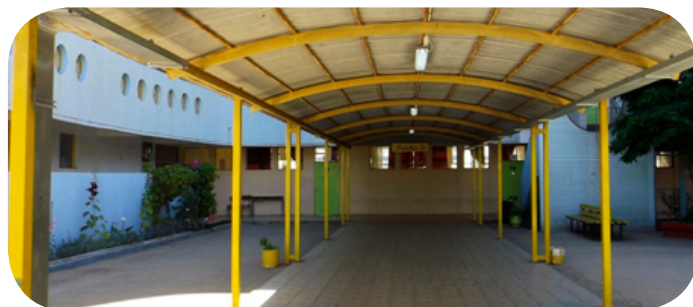
Las canaletas superiores del pasillo principal y sus luminarias también dan cuenta de las mejoras en las instalaciones eléctricas del establecimiento.
